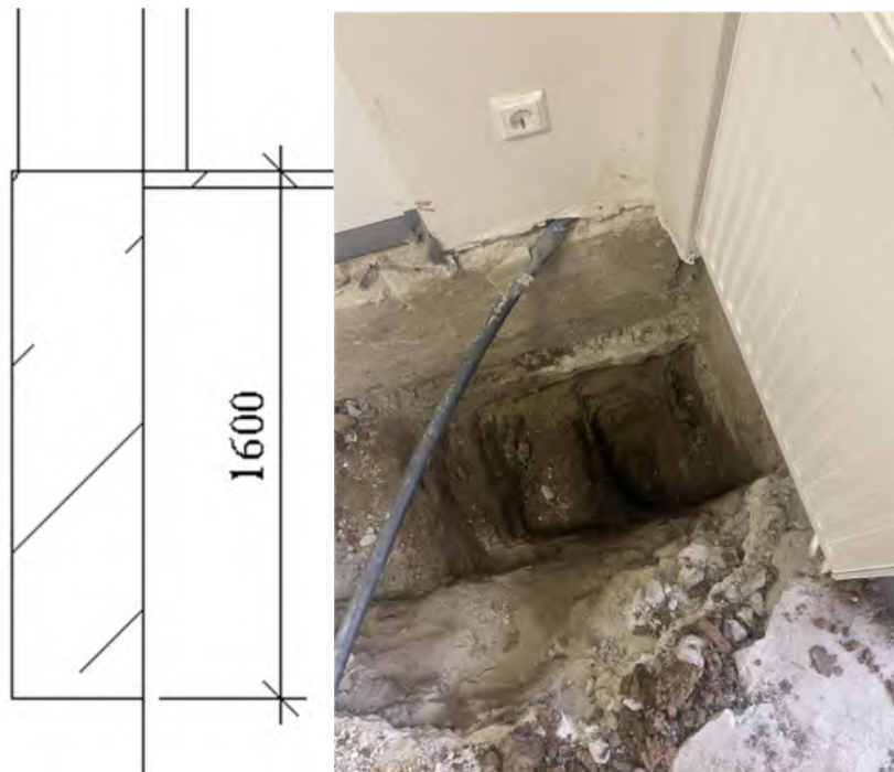
26 pav. Pastato Nr. 4 išorinės sienos pamatas
