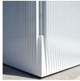
Vakariniame pastato fasade į Prezidentūrą numatoma įrengti baltos spalvos lameles įsiliejančias į fasado plokštumą
