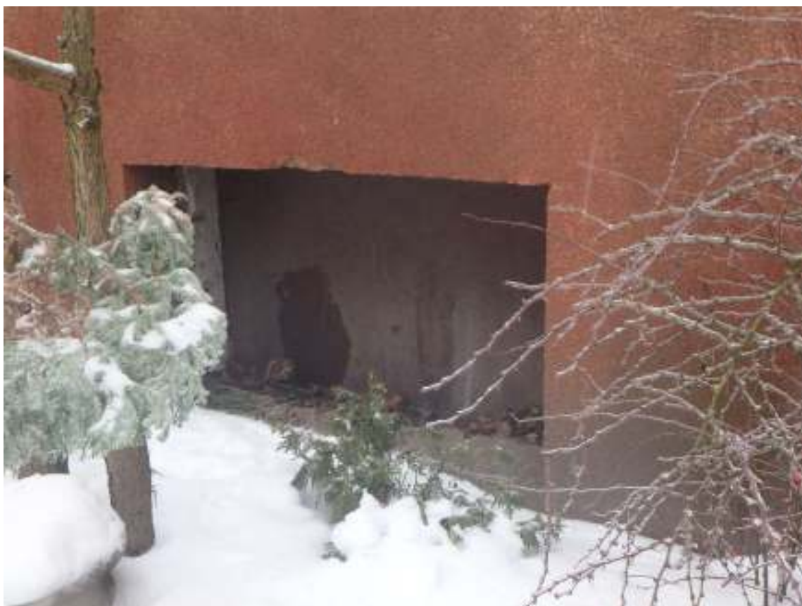
FF-10. PV fasado cokolinio aukšto lango netektis
