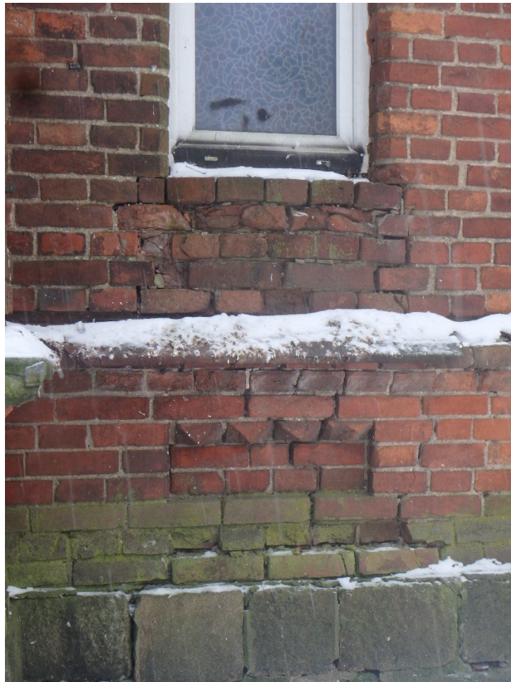
FF-8. Erodavusių plytų netektis
