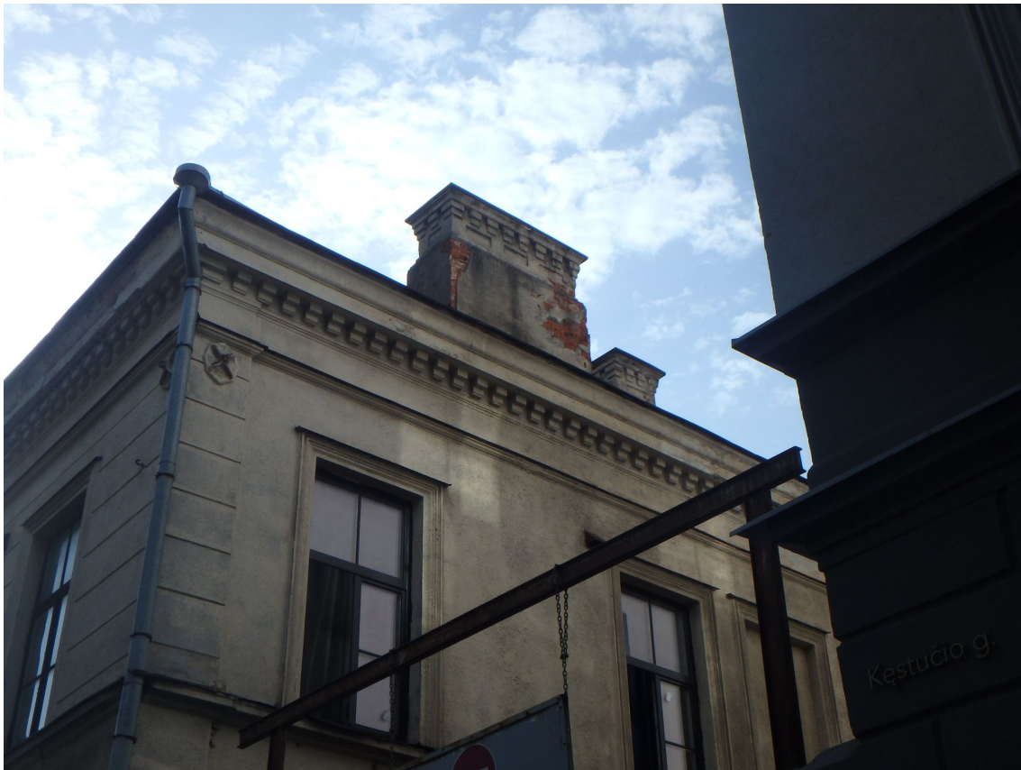
FF-9. V fasado fragmentas. Fasadų apdailos ir puošybos elementai, angos, langai, kaminas.
