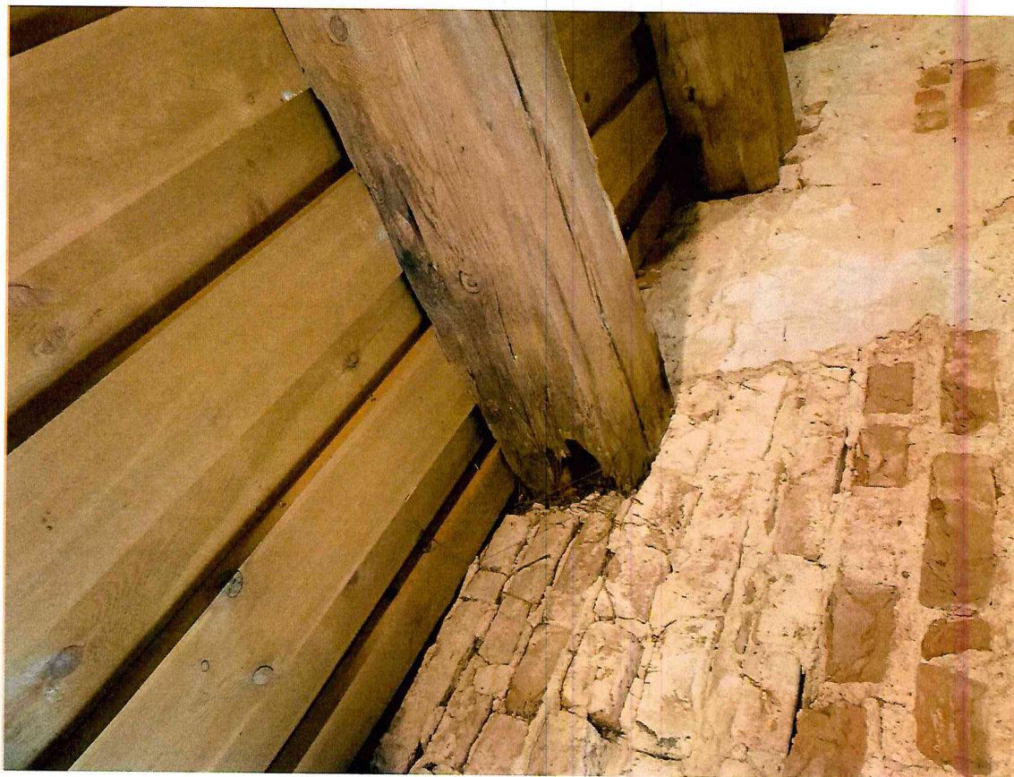
FF-19. Medinės konstrukcijos ištrupėjimas ties atrėmimu..
