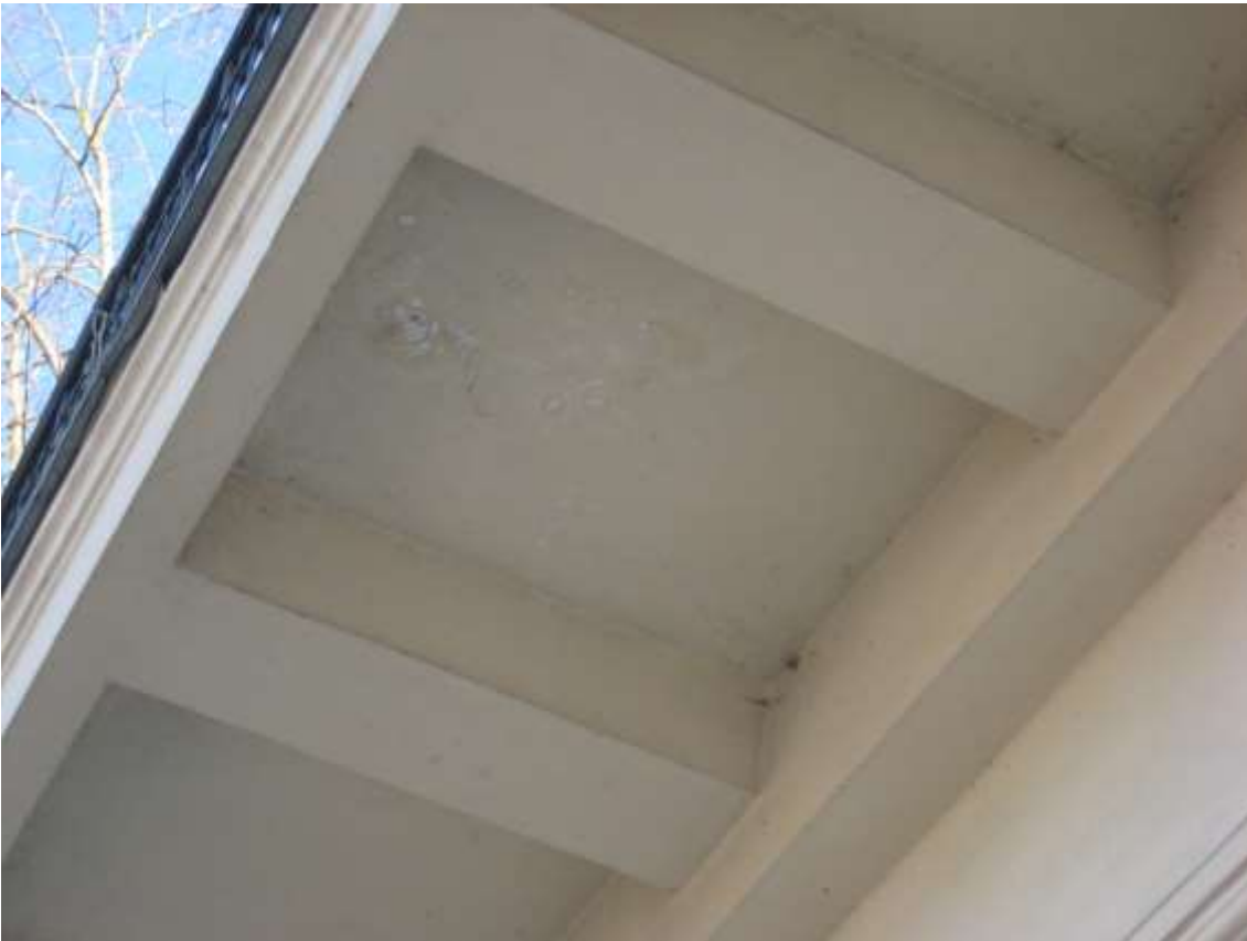
FF-27. Drėgmės pažeidimai ant balkono tinko
