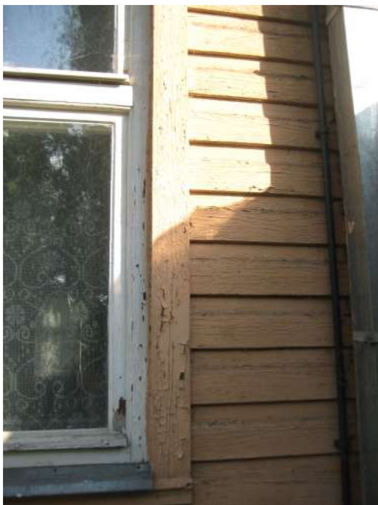
FF-18. Pažeistas medinių dailylenčių apsauginis sluoksnis
