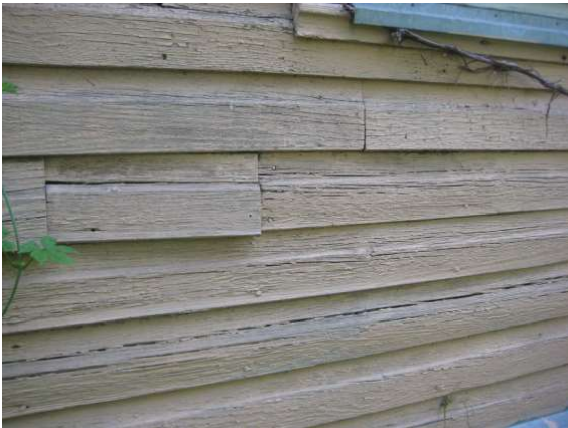
FF-19. Pažeistas medinių dailylenčių apsauginis sluoksnis
