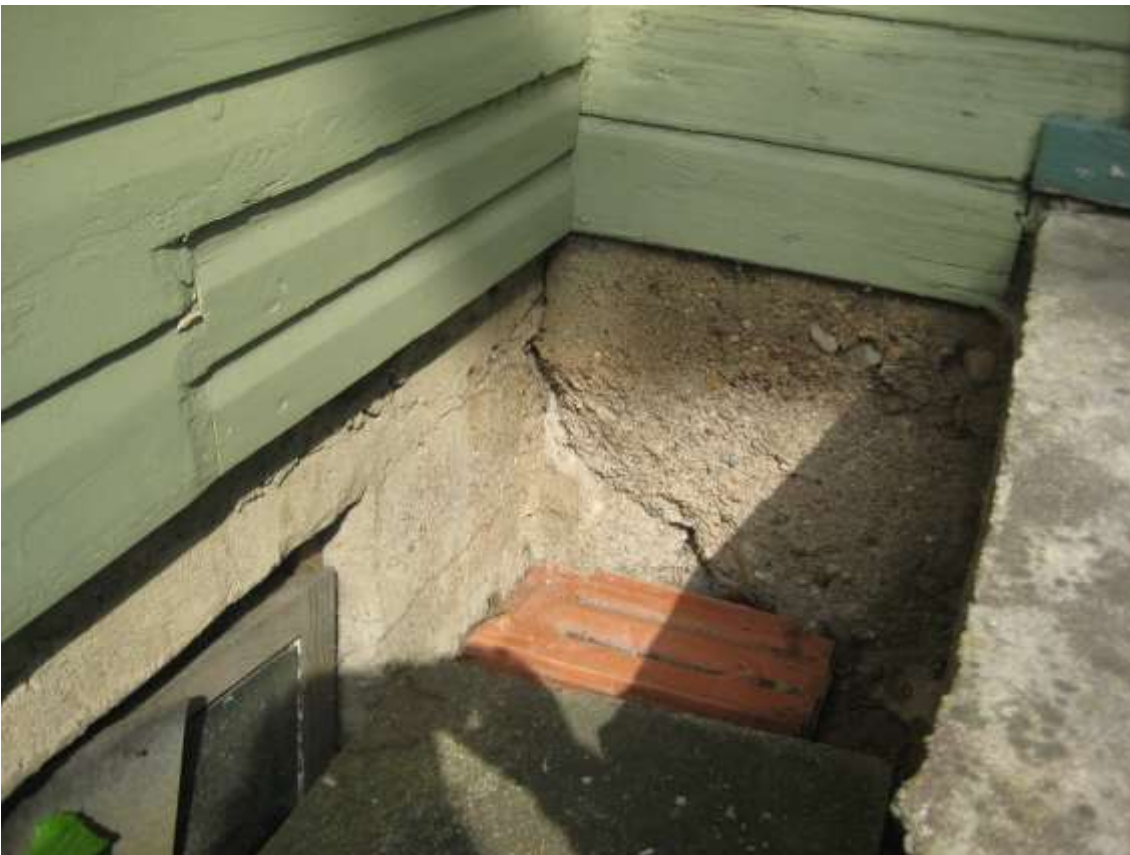
FF-12. Sutrūķes pamatas namo ŠR pusēje, ties priestatu
