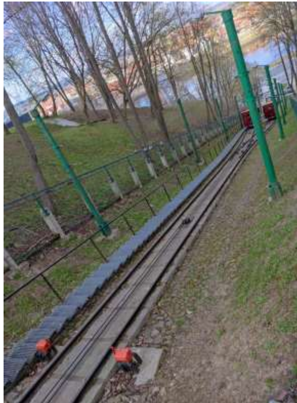
Nr. 3 Pavadinimas Aleksoto funikulieriaus statinių kompleksas Fotografavo Skaistė Dikaite ir Kamilė Muravjovaitė Data 2021-04-28
