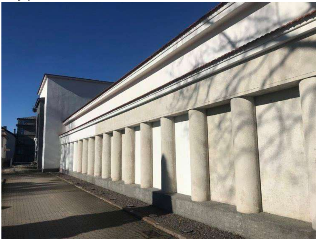
FOTOFIKSACIJA. Kauno Žaliakalnio vandentiekio stoties pastatų komplekso vandens rezervuaras. Fotografavo – Dovilė Miliukštė, 2021-03-05.
