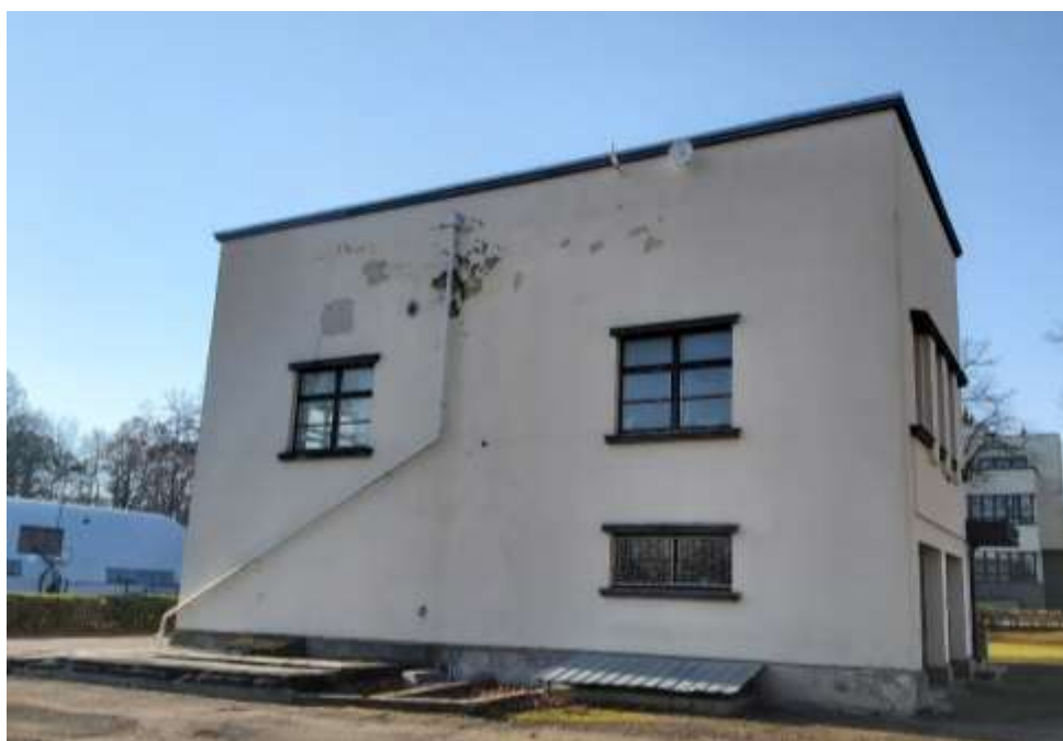
Nr. 5 Pavadinimas Ginklavimo valdybos tyrimų laboratorijos pastatų komplekso ūkinis pastata Fotografavo Danguolė Jonušaitė Data 2021-11-05
