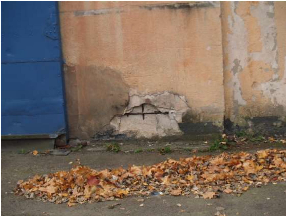
FF-10. Nukritus betono apsauginiam sluoksniui, atsidengė sienos armatūra, kuri neigiamai veikiama atmosferos poveikio
