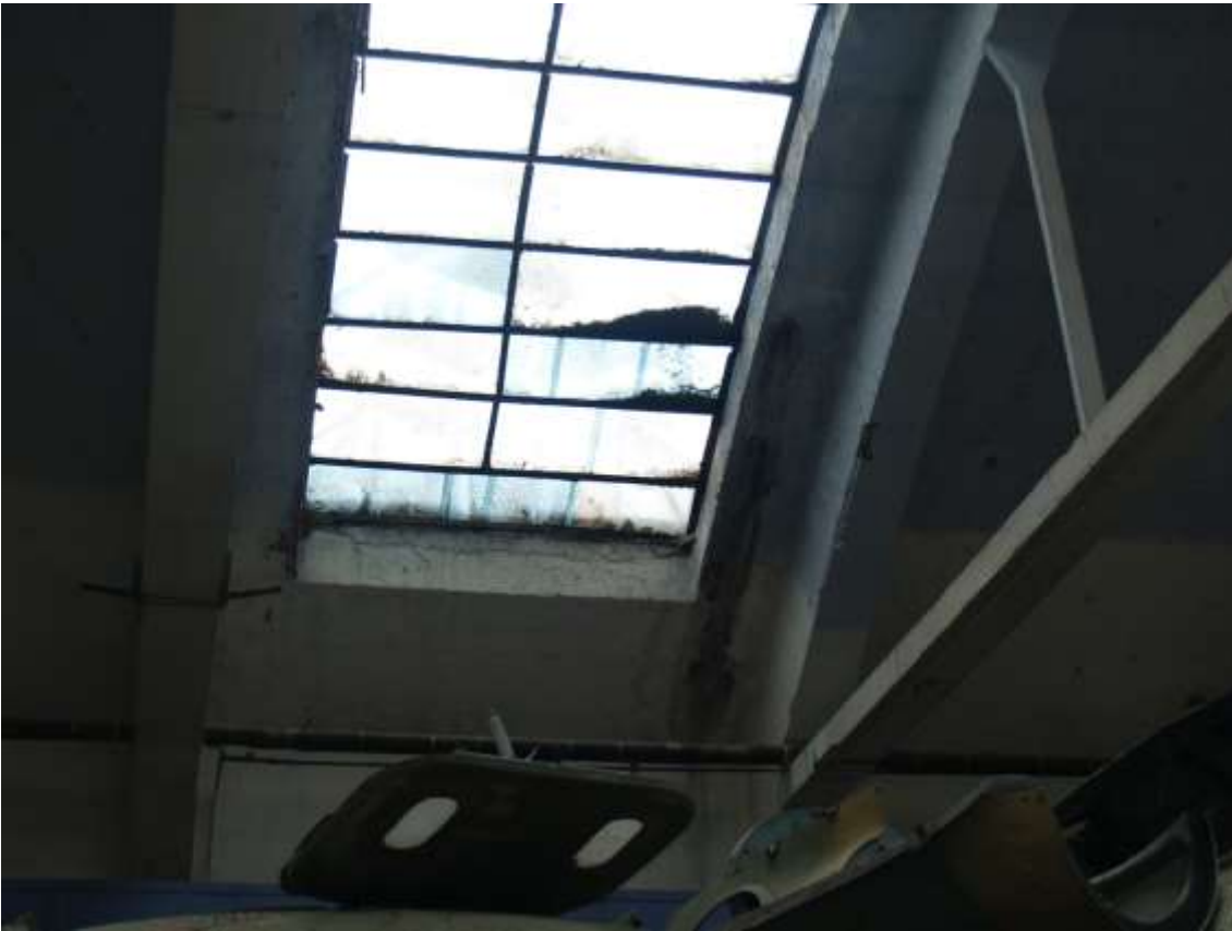
FF-15. Nesandarus stoglangio rėmas, pro kurį drėgmė patenka ant g/b konstrukcijų. Rėmas paveiktas korozijos
