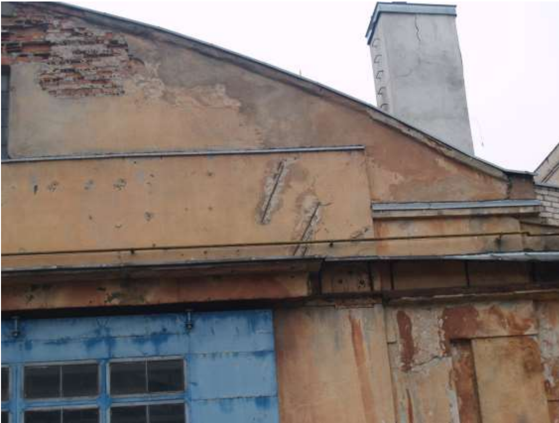
FF-9. Pažeistas gelžbetoninis sienos elementas, matoma atvira armatūra
