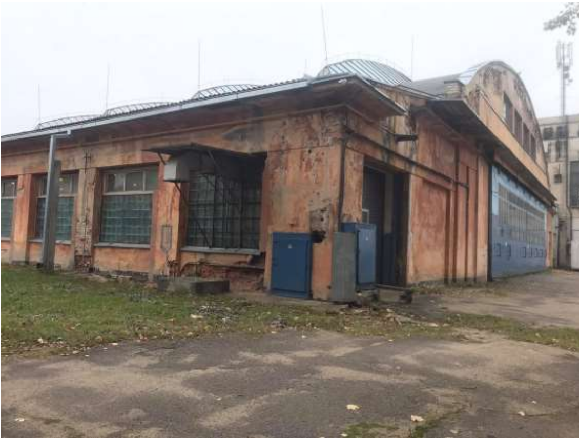
FF-3. ŠR fasadai su vertingosiomis savybėmis. Matomas stipriai pažeistas plytų mūras ties cokoliu, pakeisti vartai
