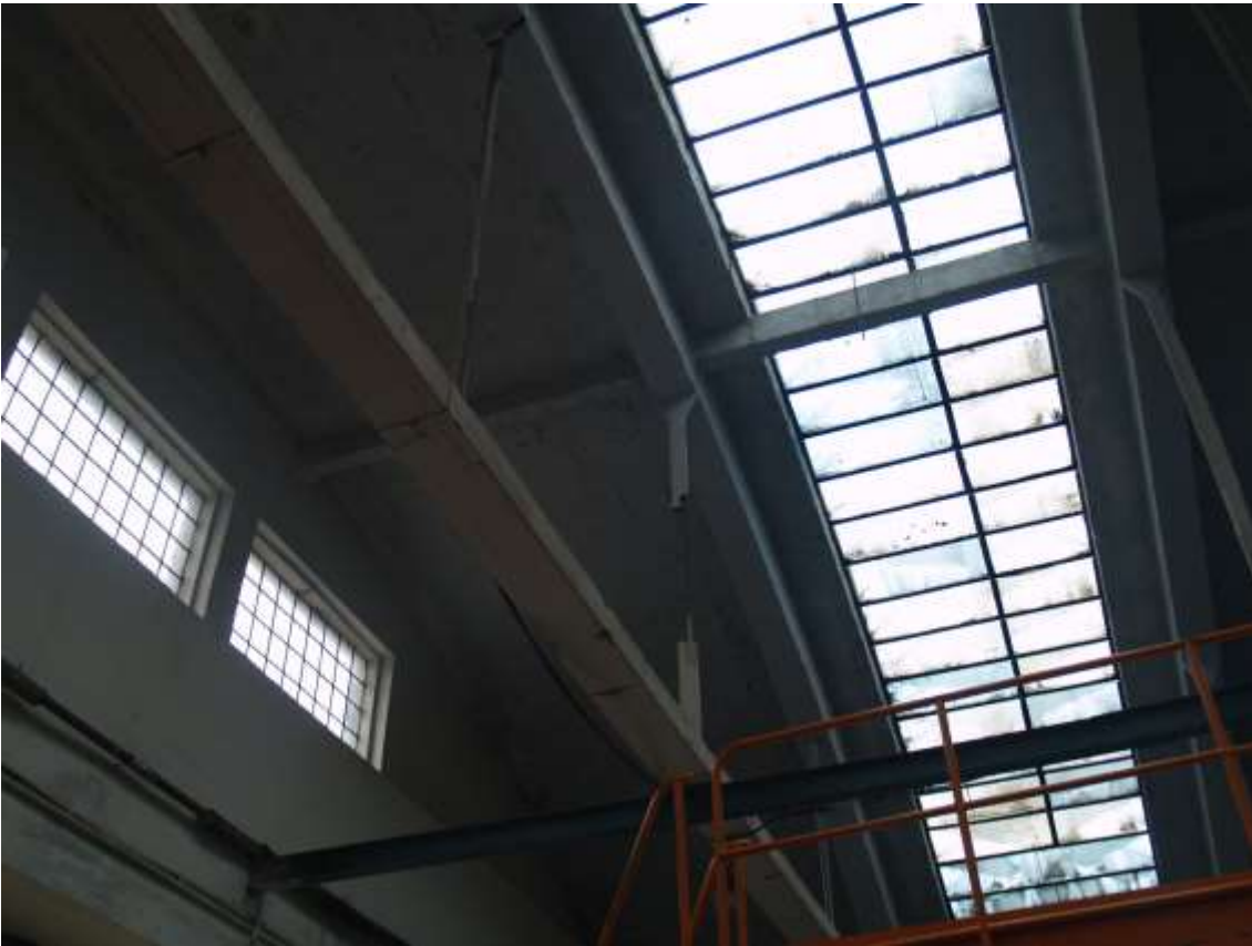
FF-17. Nudaužytas santvaros elementų apsauginis betono sluoksnis
