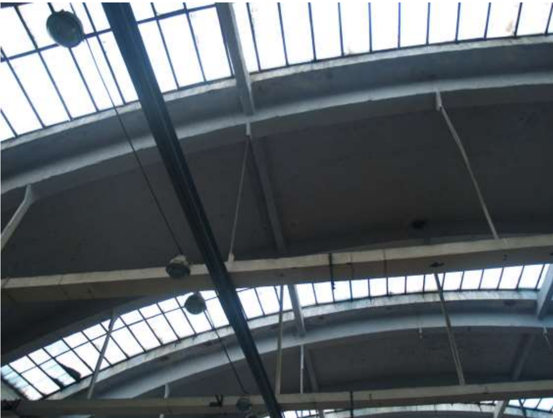
FF-14. Santvaros tarpinių elementų betonas nudaužytas, pasilikę matomi lynai
