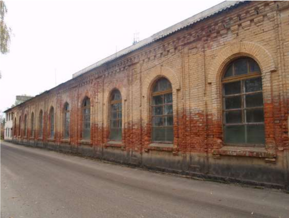
FF-3. V fasadas su vertingosiomis savybėmis. Matomas gerokai erozijos paveiktas plytų mūras
