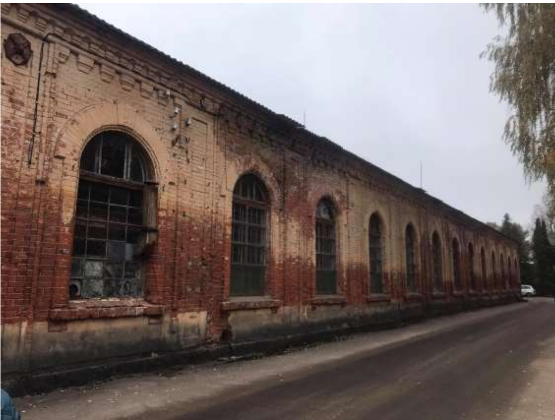
FF-4. V fasadas su vertingosiomis savybėmis. Langų rėmai pažeisti korozijos, trūksta stiklų
