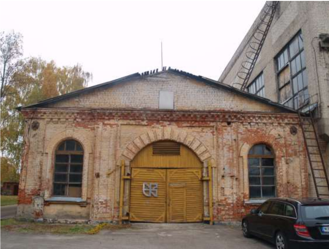
FF-1. P fasadas su vertingosiomis savybėmis. Frontonas išmūrytas silikatinėmis plytomis. Pažeista stogo konstrukcija
