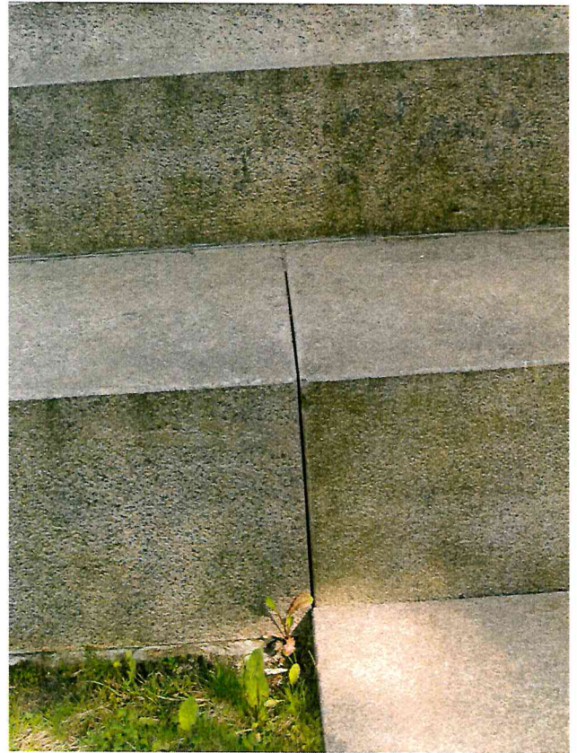
8 pav. Atviros siūlės paminklo cokolyje
