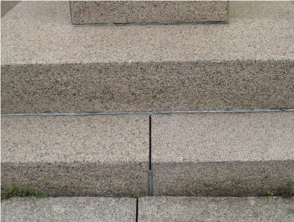
5 pav. Atvira siūlė tarp cokolio atskirų granito elementų
