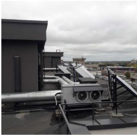
Visi laiptinės butų vėdinimo kanalai ortakiais sujungti bendrai ir prijungti prie ventiliatoriaus per šilumos siurbį.
