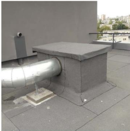
Vėdinimo šachtos apšiltintos.
