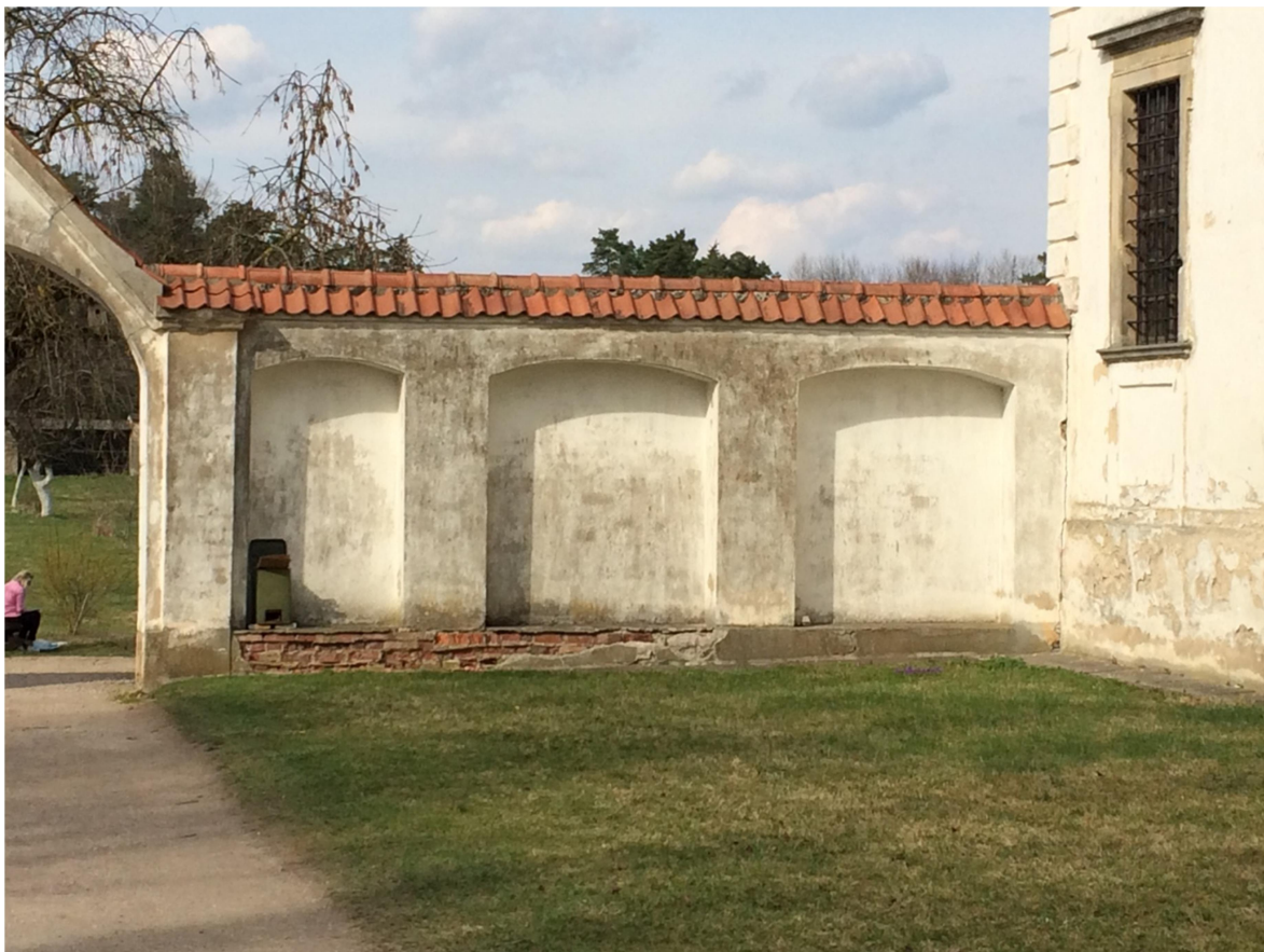
13.3. Šventoriaus vartų pamatų būklė iš P pusės (F-3)
