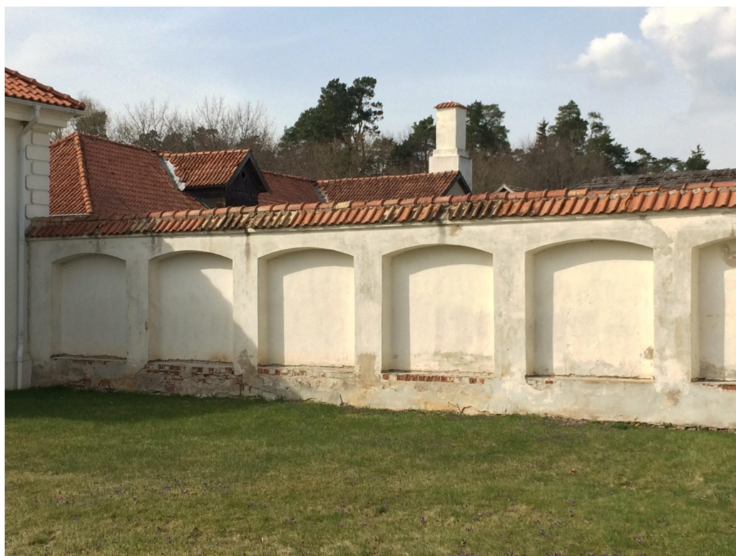
13.2. Šventoriaus vartų pamatų būklė iš P pusės (F-2)
