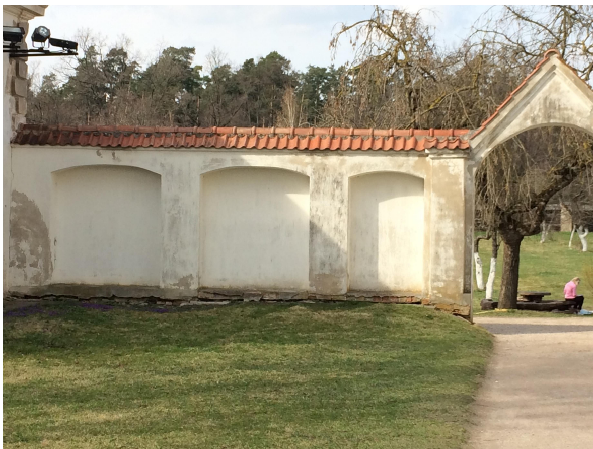
13.4. Šventoriaus vartų pamatų būklė iš P pusės (F-4)
