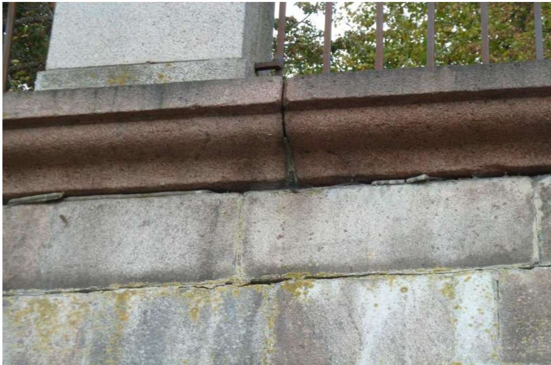
F18. Profiliuotos Prieplaukos g. pietinės atraminės sienos profiliuotos karnizų plokštės Fotografavo N.Steponaitytė. 2016-10-18
