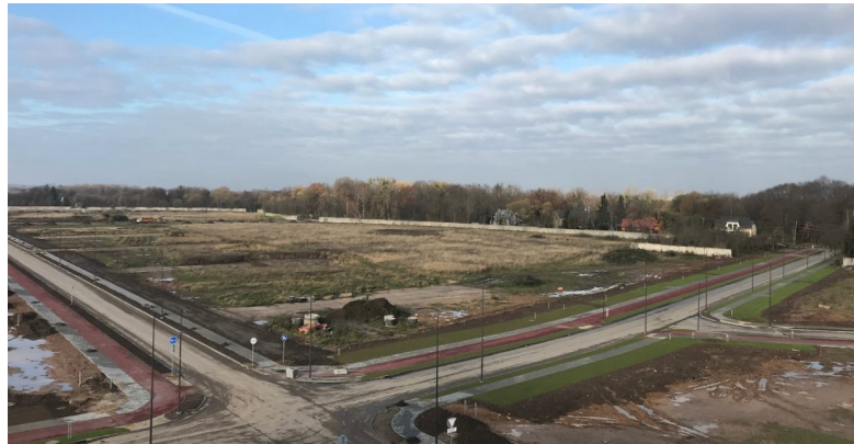
pav. 14 Aleksoto inovacijų pramonės parko (AIPP) teritorijoje 2020 metais baigta įrengti susisiekimo infrastruktūra
