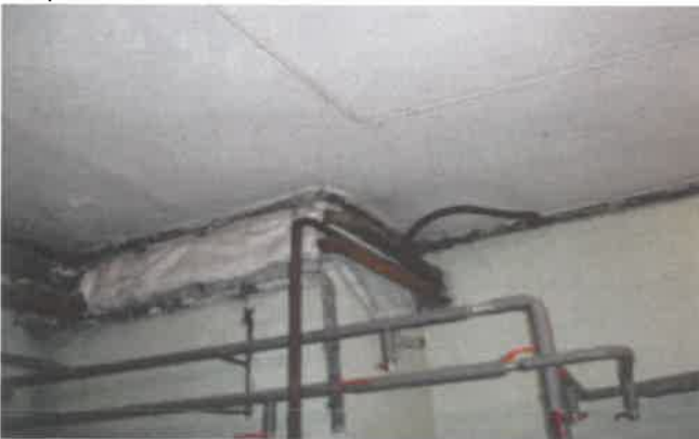
21 pav. Karšto vandens vamzdynai
