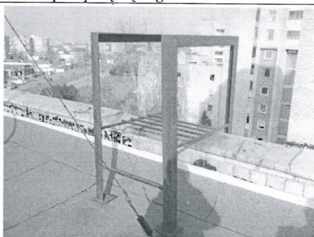
Surūdiję priešgaisrinės kopėčios
