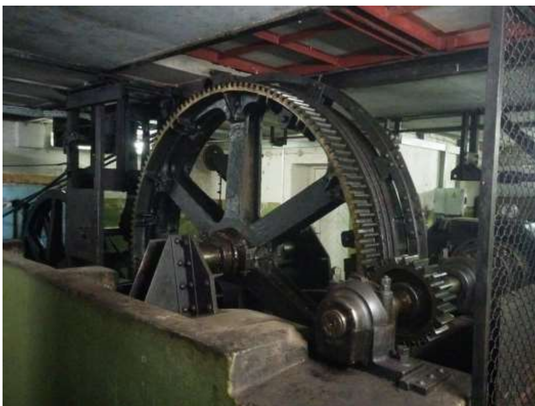
(F-6). Vagonų traukos mechanizmo fragmentas. Varomasis krumpliaratis, didysis vedantysis skriemulys su krumpliaračiais;
